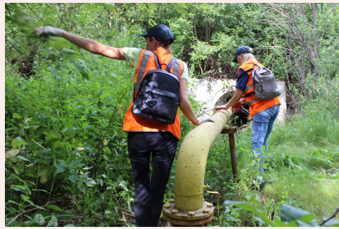
И зимой, и летом трубы требуют тщательной проверки
